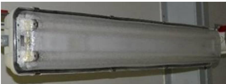
Figur 5. Befintlig armatur som ska byggas om och återbrukas i samma byggnad.
