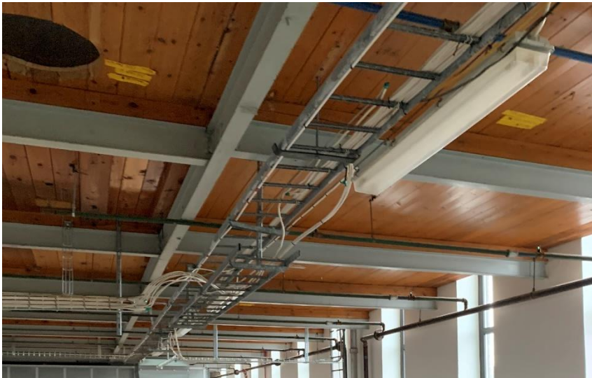
Figur 4. Befintliga kabelstegar som ska återbrukas i samma byggnad.
